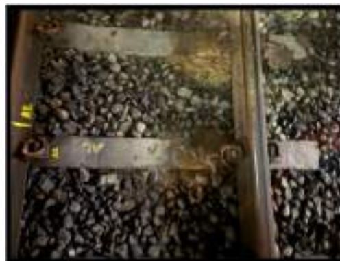
Gambar II. 9 Mud Pumping pada titik ALA
