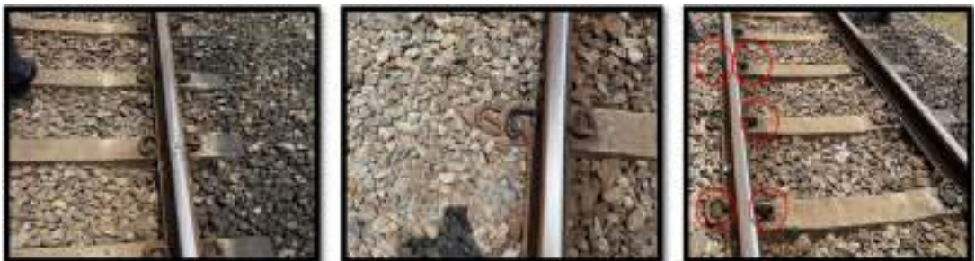
Gambar II. 8 Kepala Rel yang Mengalami Cekungan atau Penyok dan Penambat yang Mengalami Korosi
